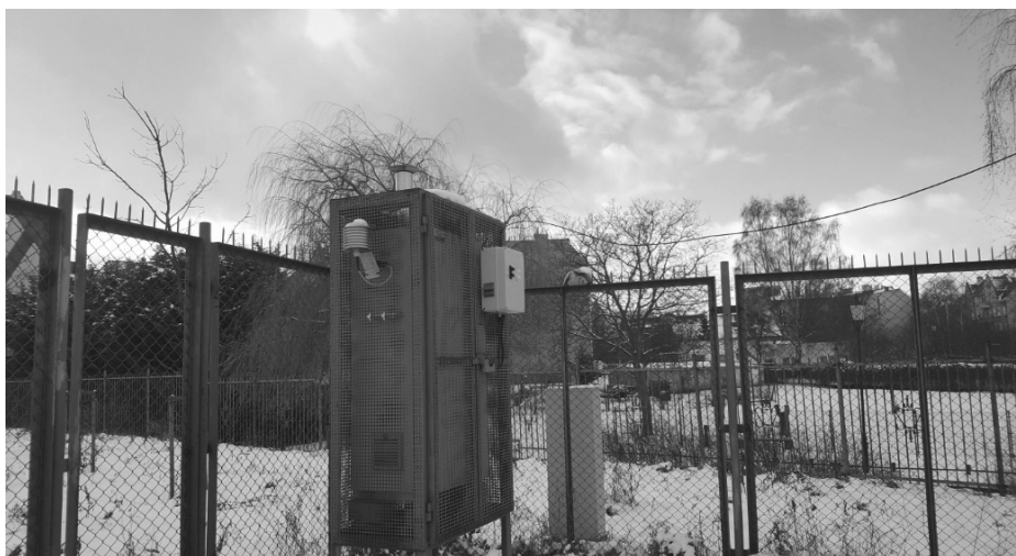
Rys. 2. Zamontowane czujniki PM_{10} (biała skrzynka) na obudowie ochronnej stacji odniesienia zlokalizowanej w Gdańsku Wrzeszczu
