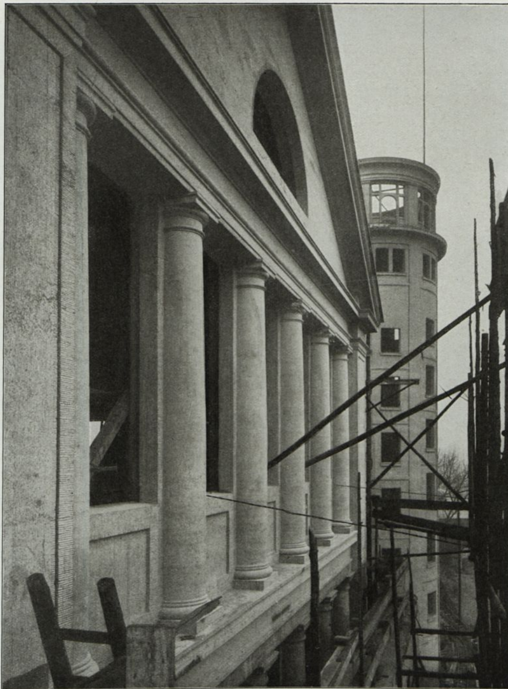
Abb. 234. Deutsches Museum, München, Siebelanbau an der Westseite. Bauteil der Firma Dyckerhoff & Widmann, A.G., München.
