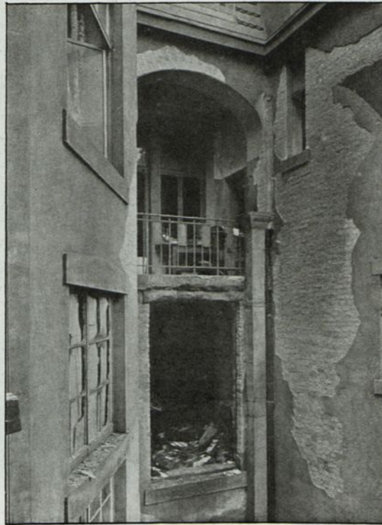
Abb. 241. Warenhaus Esders, Dresden, Sandsteinsturz nach dem Brande.
