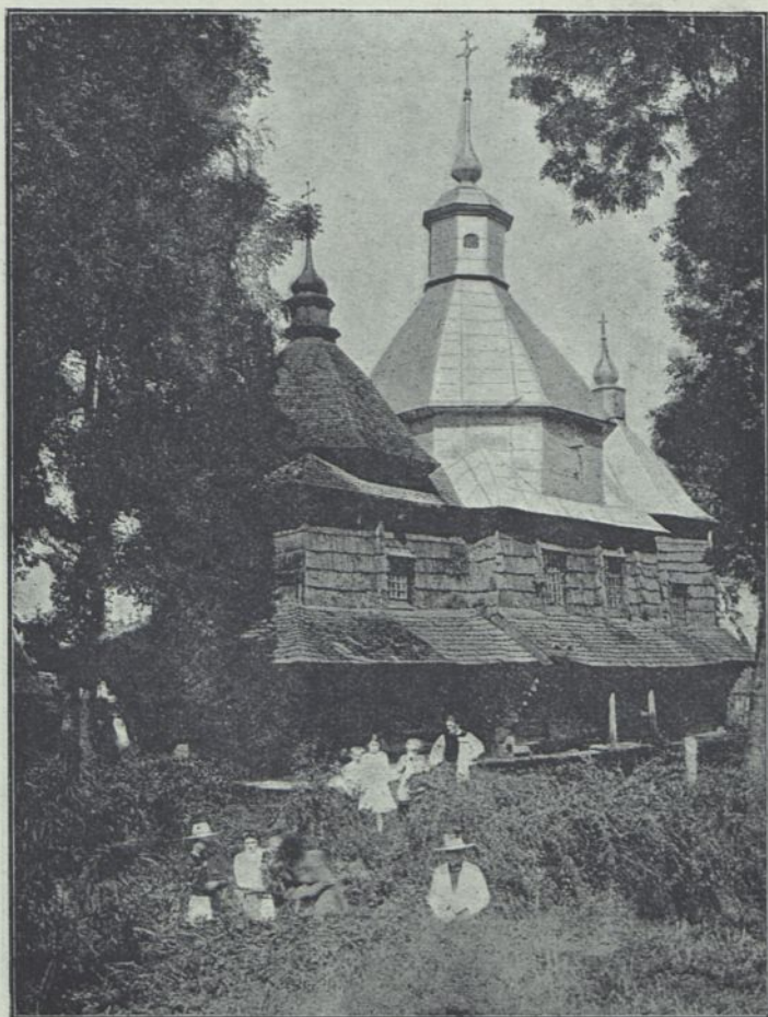
Fig. 15. Cerkiewka św. Michała w Gródku Jagiellońskim. Przykład ujemny krycia blachą budowli drewnianych.
