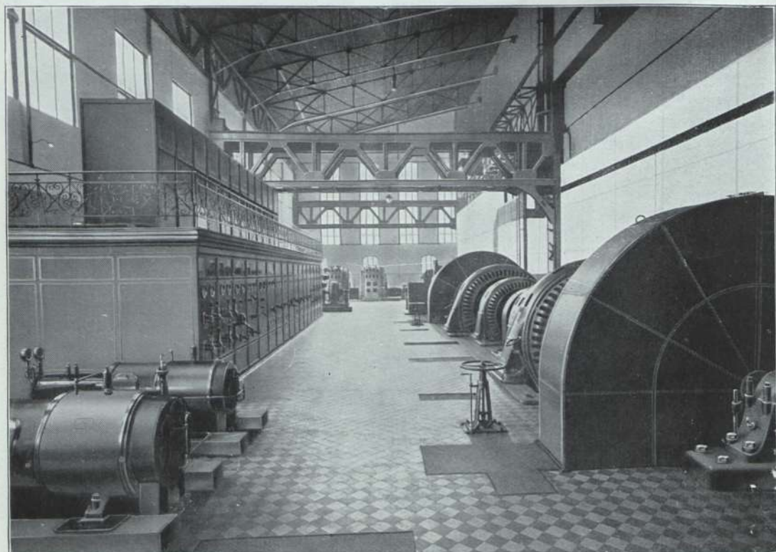
Maschinenraum für die Umkehrwalzenstraße auf der Julienhütte D.-S. Rechts der Iglner-Umformer, im Hintergrund die Walzenmotoren.
