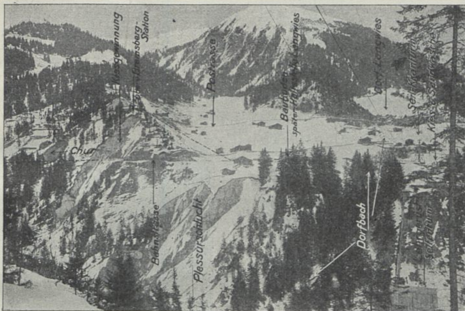
Fig. 26. Ansicht der rechten Talseite bei der Brückenstelle mit Anordnung der Baueinrichtungen. Bauzustand am 15. Februar 1913.
