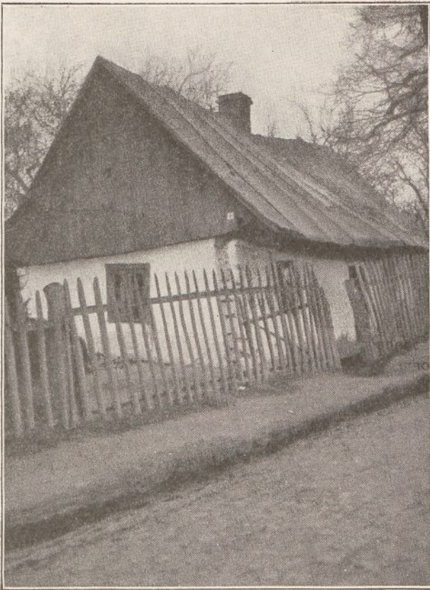
Wohnhaus des Hoshčůtky in Rudnik, Landkreis Ratibor. Typisches Beispiel für den Ersatz ehemaliger Strohdächer durch Dachpappe. Für diese ist die Dachneigung zu steil, so daß der Teer schnell herunterläuft. Das Dach wird undicht und der Dachstuhl fault zusammen.
