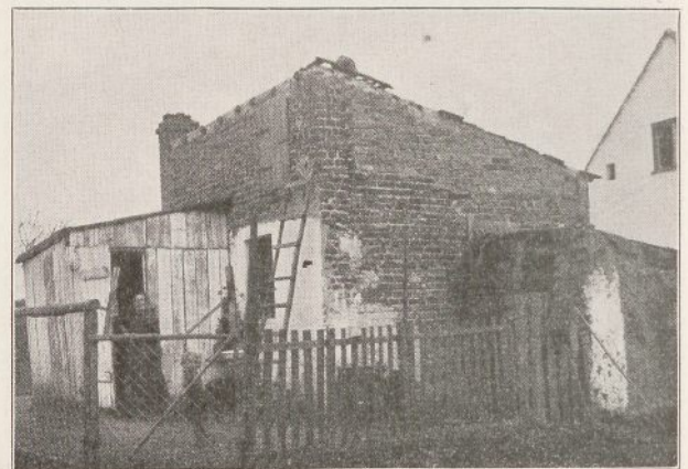
„Neubau“ von 1928 in Lonschnik, Kreis Neustadt OS. Bewohnt von 1 Familie mit 6 Kindern. Auf dem Wege der Selbsthilfe errichtet. Sie besteht aus nur 1 Raum von 15 qm. Fußboden ist nicht vorhanden. Der Urtypus des Kernhauses.
