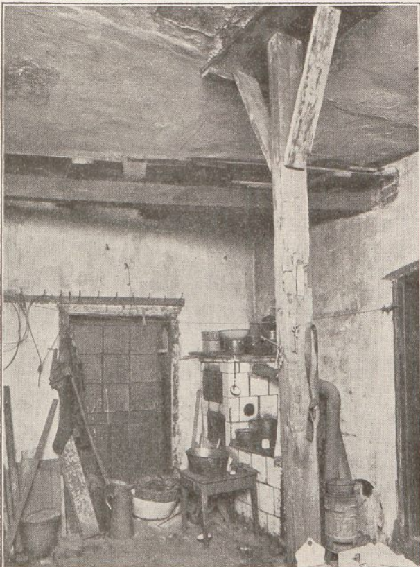
Beuthen OS., Kluckowitzer Straße 8. Durch Balken gestützte Decke; für baufällig erklärt, aber noch bewohnt.
