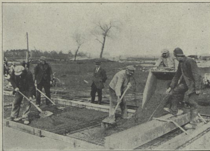
Abb. 18. „Occident“-Bauweise. Das Gießen der Wandplatten von oft 10 m Länge und 3 m Höhe.
