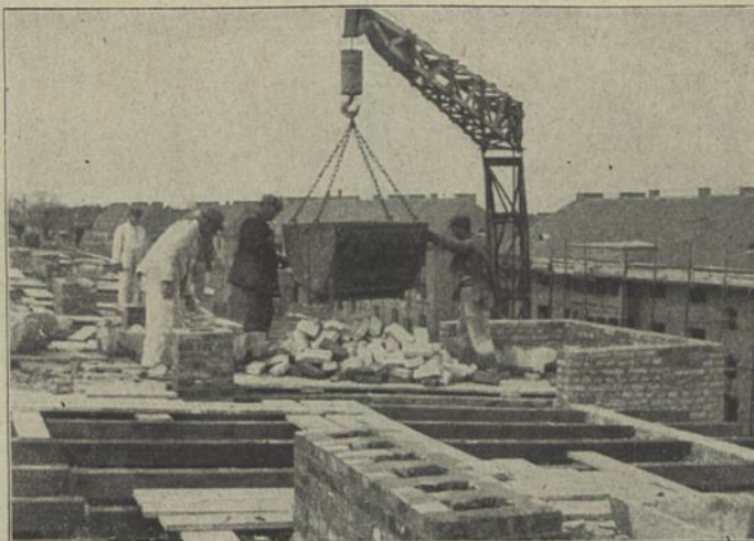
Abb. 16. Der Kran legt dem Maurer die Ziegelsteine auf das Baugerüst im vierten Stock.
