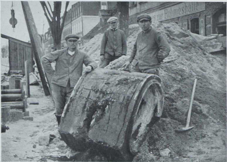
Abb. 6. Bloßgelegtes zerstörtes Kanalrohr 1,05/0,70 m der Kanalisation Erlangen, von oben gesehen.
