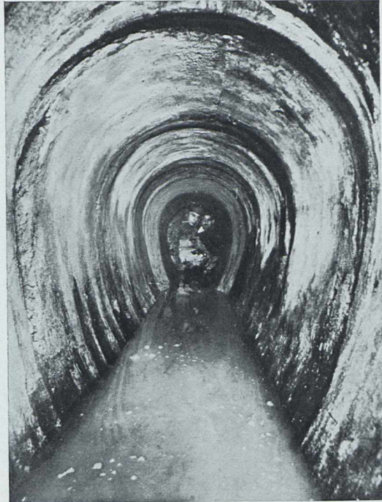
Abb. 5. Zerfressenes Kanalrohr 1,05/0,70 m der Kanalisation Erlangen.
