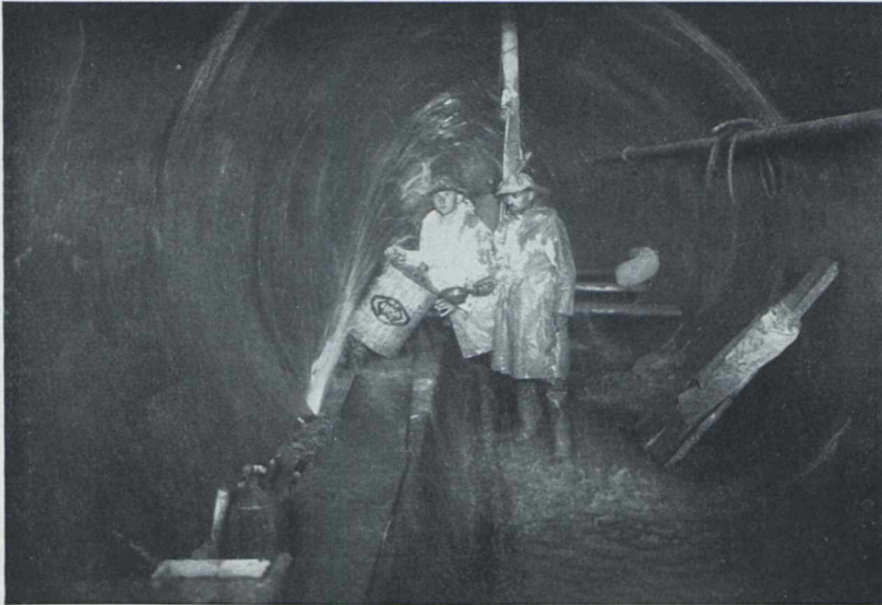
Abb. 3. Undichte Stellen im Sulgenbachstollen in Bern, erfolgreich gedichtet 1926 mit Sika Nr. 2 und 4 unter Wasserdruck bis 3,2 Atm. Lichter Kanaldurchmesser 3 m.
