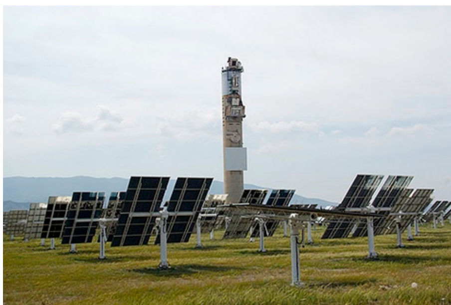
Pole heliostatów systemu CESA-1
