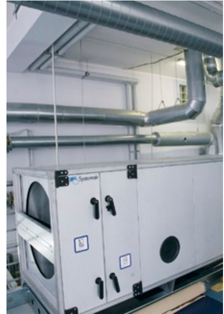
Tak wygląda centrala klimatyzacyjna
