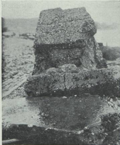
BILD 23. In den Stampffugen durch Meerwasser zerstörter Beton auf Helgoland
