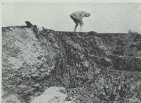
BILD 27. Helgoland. Mit Tang und Muscheln dicht bewachsener Beton, der unter dieser „Schutzschicht“ zerstört wurde. (Der Zerfall ist links vorne deutlich zu sehen)
