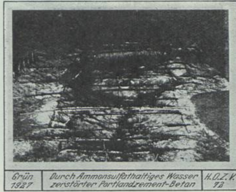
BILD 33. Durch ammoniumsulfathaltiges Wasser zerstörter Beton in einer chemischen Fabrik in Ludwigshafen
