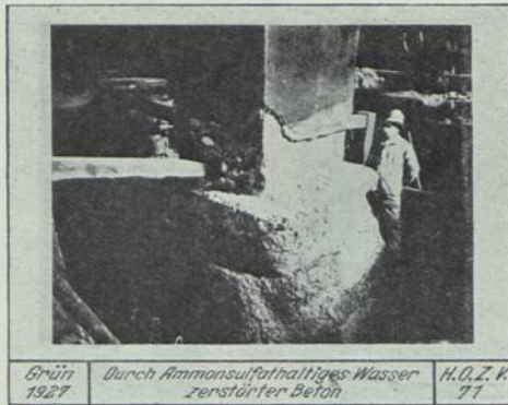
BILD 34. Durch ammoniumsulfathaltiges Wasser zerstörter Portlandzement-beton in der chemischen Fabrik der I. G. Farbenindustrie A. G. Ludwigshafen
