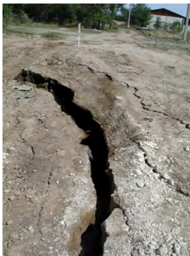
Rys. 3.26. Zapadnięcia i rozwarstwienie na granicy obszaru wzmocnianego
