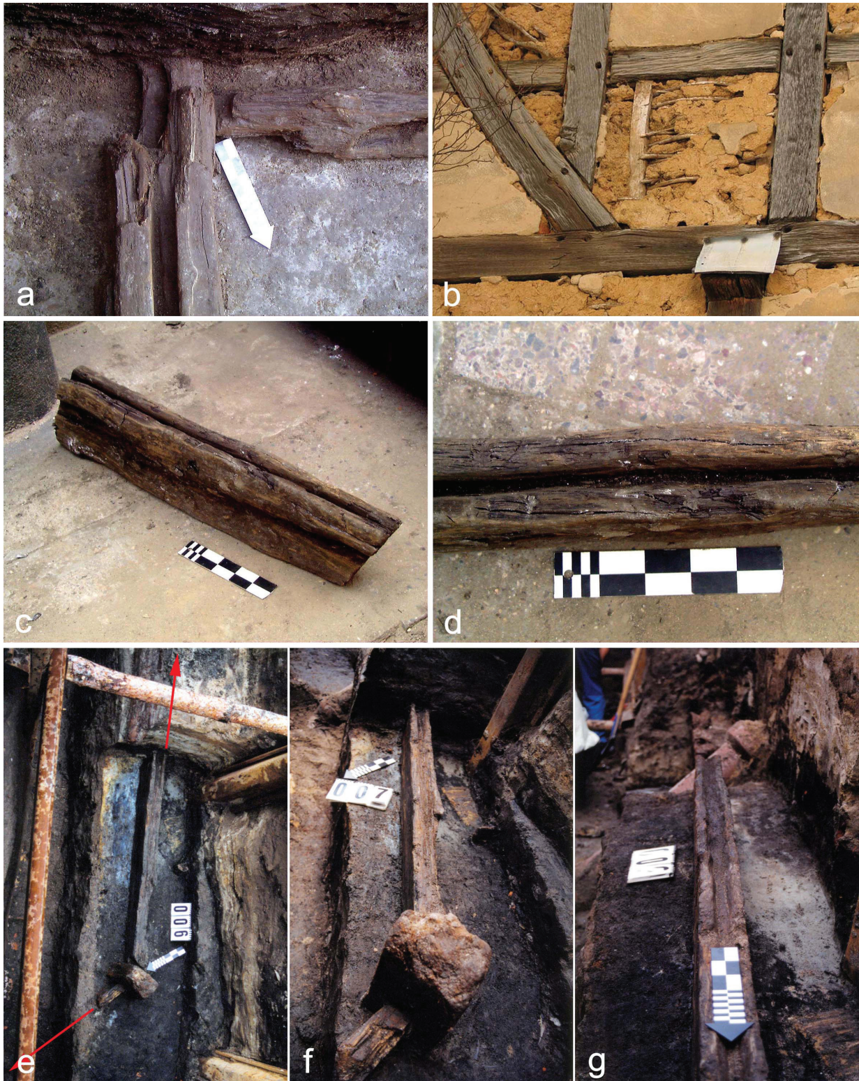
Il. 1. Relikty XIII-wiecznych konstrukcji szkieletowych: Wrocław: a) Kurzy Targ – narożnik budynku w konstrukcji ramowo-słupowej, datowanego dendrochronologicznie na czas po 1230 r.; b) typowe wypełnienie szkieletu drewnianego z użyciem strychulców, plecionki i gliny; c), d) pozyskany na wtórnym złożu tzw. rygiel przyciesiowy (przecięty w trakcie eksploracji); e)–g) ul. św. Marii Magdaleny – relikty płotu w konstrukcji słupowej z ryglami przyciesiowymi, datowanego dendrochronologicznie na czas po 1239 r. (fot. R. Mruczek, 1998–1999)
