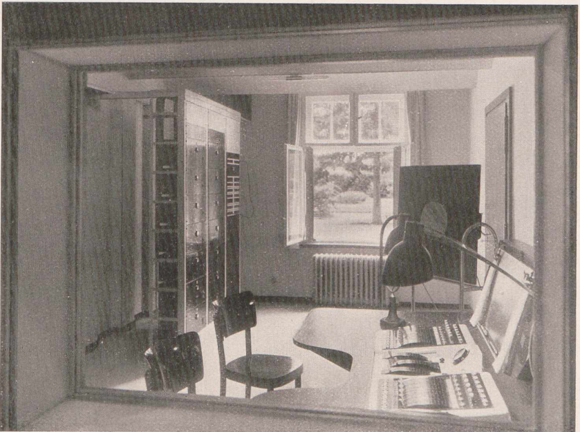
Blick durch das Regiefenster auf den Regietisch mit den Regel- und Kommandoeinrichtungen Im Hintergrund die zugehörige Verstärkeranlage
