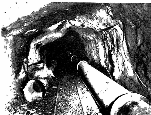
Rys. 12. Przewody wentylacyjne w sztolni.
