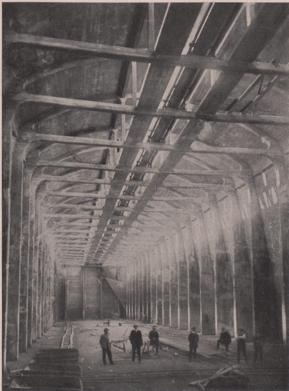
Abb. 125. Rohschwefelsilo, Marseille, Wayss & Freytag
