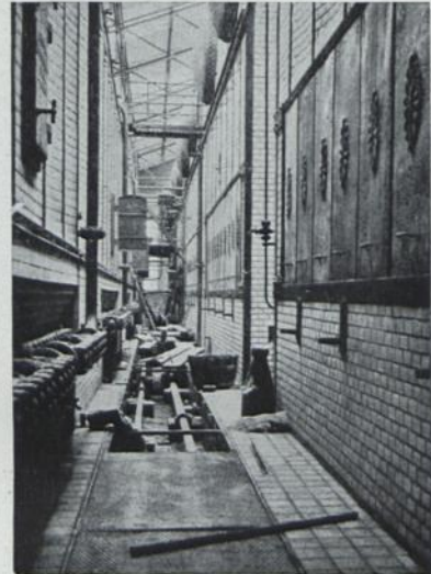
8 Kesseleinmauerungen mit Ekonomiser, für Kraftwerk „Zukunft“, Weißweiler
