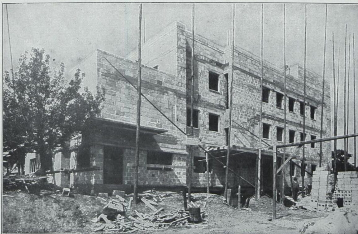
Siedlungsbau 5 (Prof. Dr. Ing. Peter Behrens, Berlin) der Werkbundsiedlung „Die Wohnung“, Stuttgart, errichtet in der Hauptsache massiv aus Bimsbeton-Hohlblocksteinen „System Hubaleck“.
