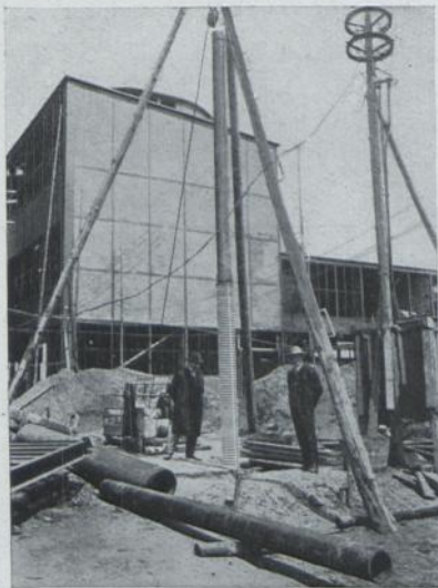
Stadt. Müllverwertung Köln: Pumpwerk mit Sammelbrunnen 4,5 Meter l. Durchmesser, Heberleitung 700 mm Durchmesser und 9 Rohrbrunnen D. R. P. a., Grundwasserabsenkungsanlage mit 5 m Spiegelsenkung.
