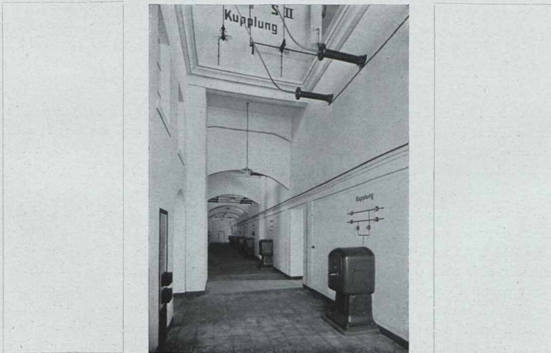
Bild 8 · Bedienungsgang im 100 KV-Schaltheis
