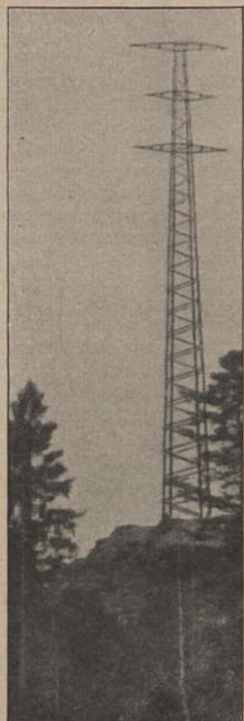
Abb. 7. 40 m hoher Mast der 110-KV-Bahnstromfernleitungen südlich der Donau, auf der Seenase am Kochelsee. Turmbauform mit Querträger für drei Erdseile.
