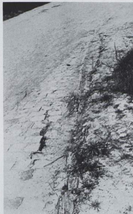
Abb. 299. Beschädigung des Straßenpflasters unter ob'ger Last. (Foto Reichsbahn.)
