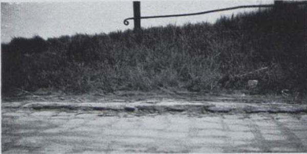
Abb. 300. Schwere Pflasterschäden bei Beförderung von 31,5 t schweren Kesseln auf Primitivfahrzeugen. (Foto Reichsbahn.)
