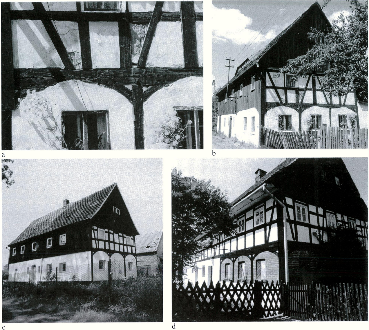
Ryc. 7. Niewłaściwie wykonywane remonty – zamurowywanie ścian wieńcowych: a), b) Wigancice, c) Włosień, d) Zapusta
