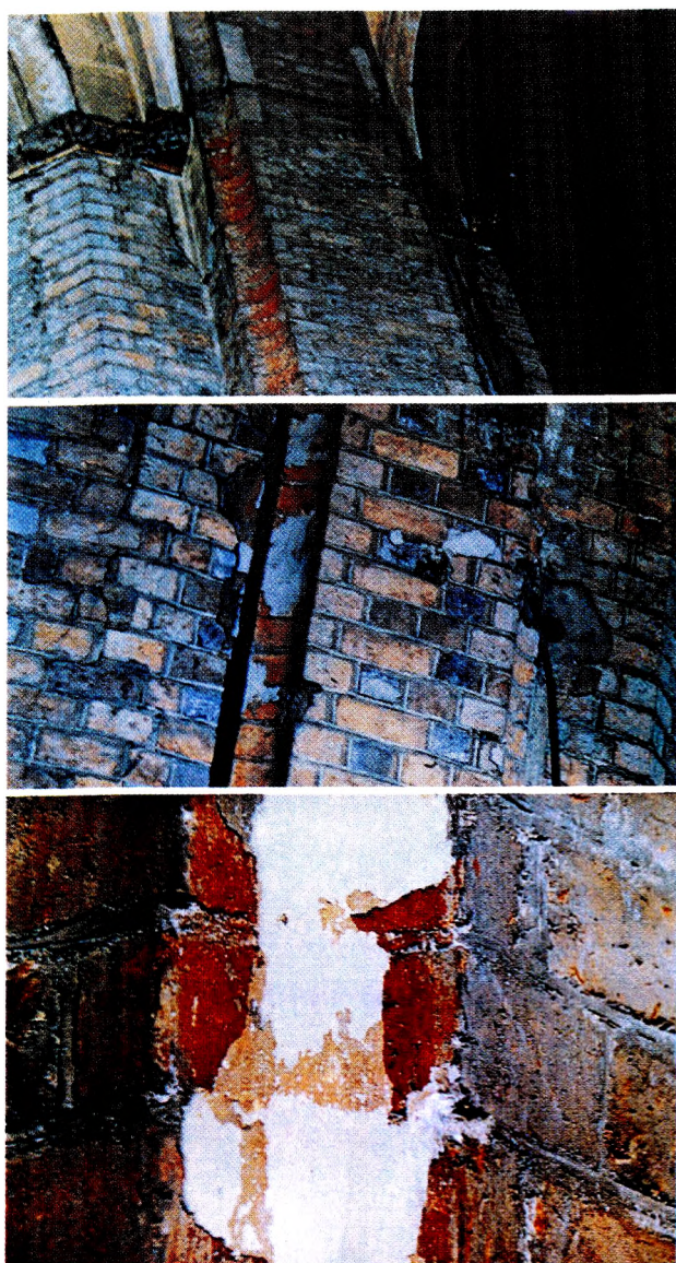
Ryc. 2. Wrocław. Kościół św. Wincentego – fragmenty zachowanej faktury i kolorystyki ceglano-wątku ścian i filarów z pomalowaniem wklęsłych krawędzi. Stan z 1962 r. (fot. autora)
