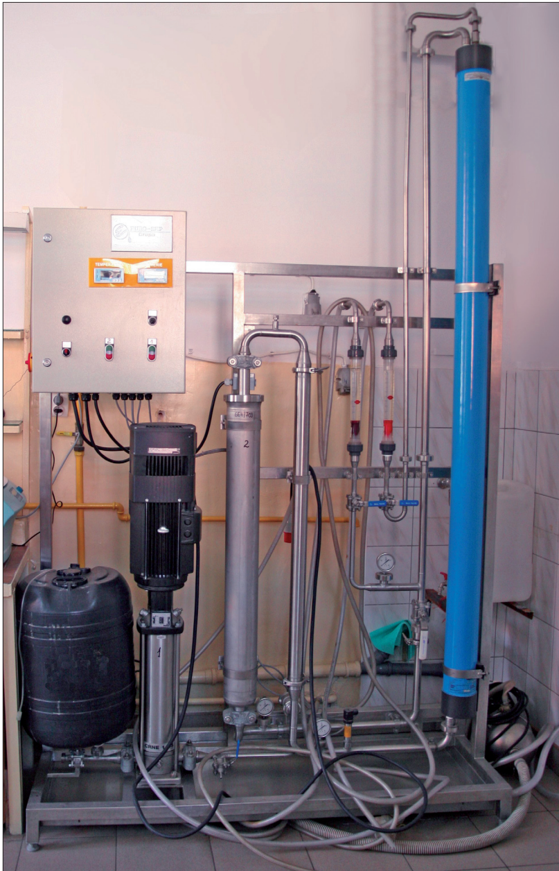
Zař. 2. Fotografia stacji nanofiltracyjnej App. 2. The photo of nanofiltration unit
