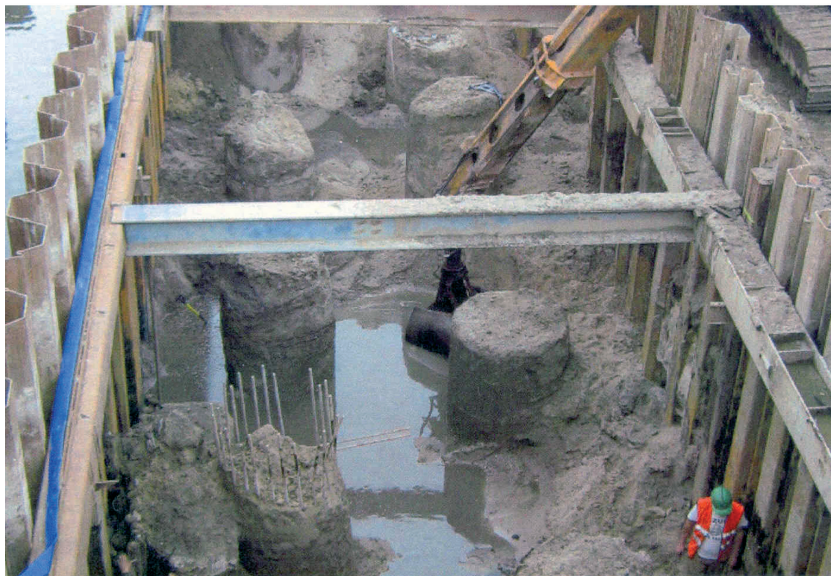
Fot. 3.10. Filtracja wody w dnie wykopu ziemnego związanego z rozbudową Mostów Warszawskich we Wrocławiu (fot. T. Molski, 2008)
