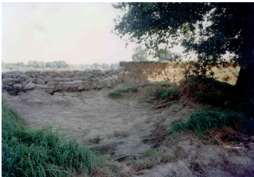
Fot. 3.4. Wał przeciwpowodziowy rz. Odry w Blizanowicach (fot. Z. Janiak, 1997) Phot. 3.4. The embankment of Odra River in Blizanowice (phot. Z. Janiak, 1997)
