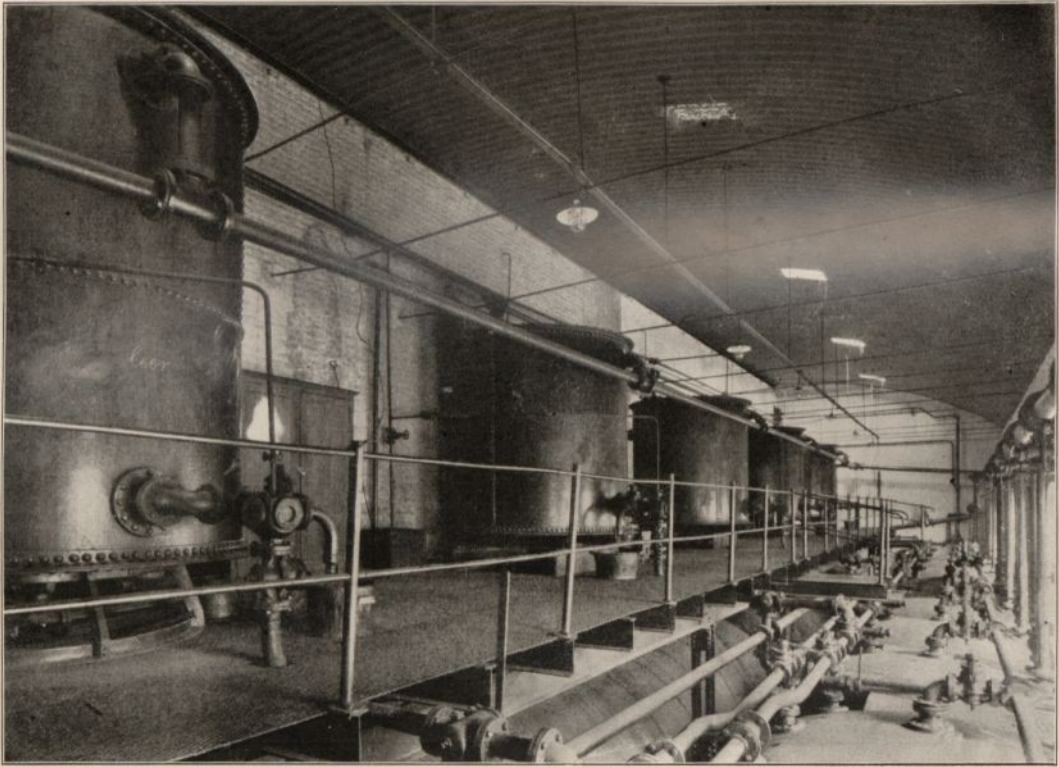
Innenansicht einer Teerdestillation (Auffangraum für die Destillate)
