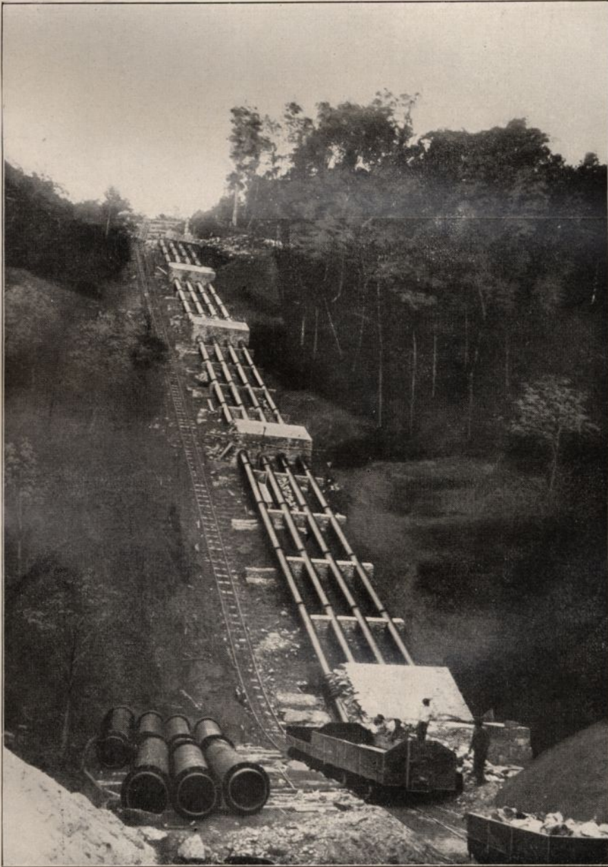
Druckrohranlage „Santos“ (Brasilien)
