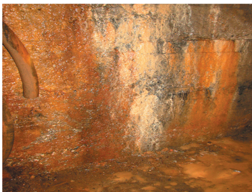
Ryc. 2. Nacieki żelaziste na obudowie betonowej (fot. W. Preidl)
