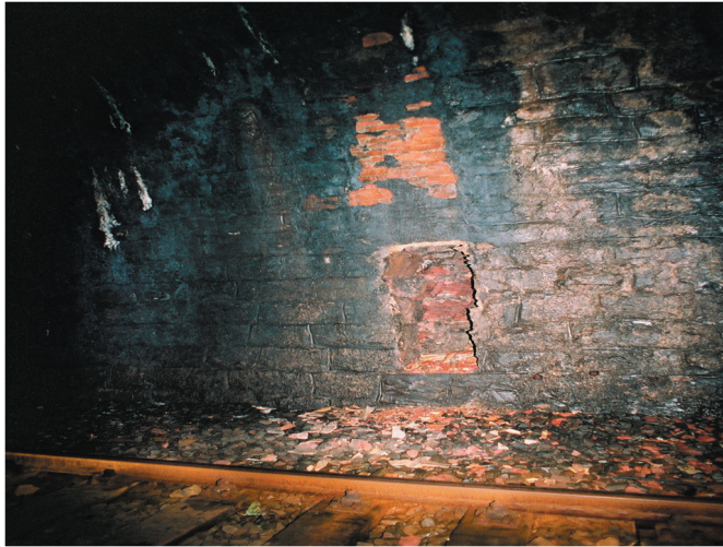
Ryc. 7. Przykład zespolonego oddziaływania fizycznych, chemicznych i antropogenicznych czynników destrukcyjnych w wyrobisku podziemnym (fot. W. Preidl)
