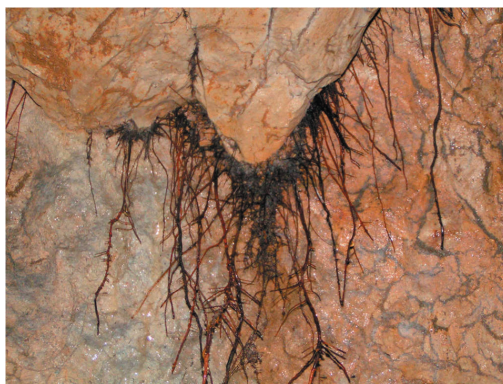
Ryc. 3. Zniszczenie struktury kamienia przez system korzeniowy drzew (fot. W. Preidl)
