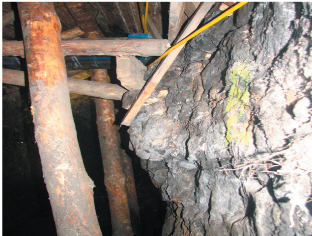
Ryc. 5. Destrukcja obudowy wyrobiska spowodowana pracami budowlanymi na powierzchni terenu (fot. W. Preidl)
