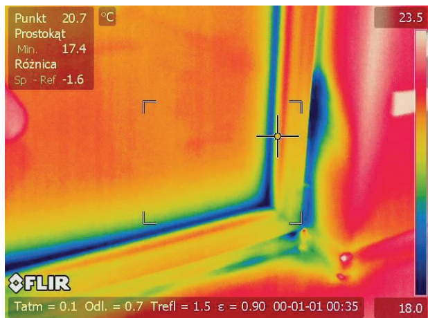
II. 1. Wadliwy i nieszczelny montaż okna powoduje znaczne obniżenie temperatury wokół stolarki okiennej
