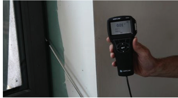
Il. 6. Monitorowanie przecieków przy użyciu anemometru Fig. 6. Monitoring leakages with the use of an anemometer
