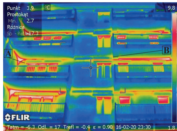
II. 2. Mostki termiczne na połączeniu płyt balkonowych ze ścianą zewnętrzną (A). Dodatkowo widoczne niedociągnięcia ocieplenia elementów wieńca i nadproży (B)
