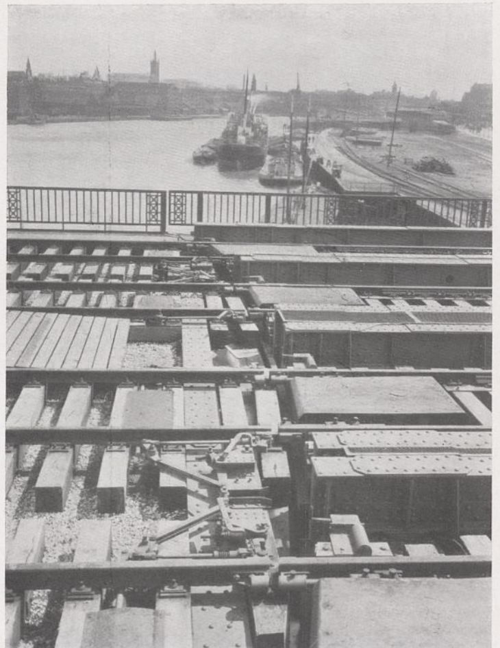
Abb. 64. Verriegelung der Schienenstöße an der Drehbrücke.
