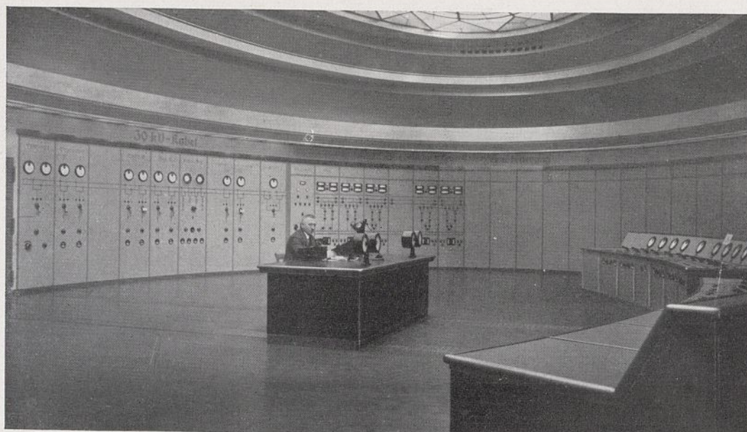
Abb. 49. Hauptschaltwerk Halensee, Schaltwarte.
