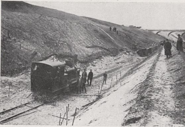
Abb. 8. Rutschung am 27. Mai 1914 mit umgeworfenem Bauzug bei km 75,5.
