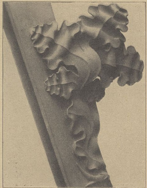
Abb. 5. Erneuerter Krabben eines Wimpergs.
