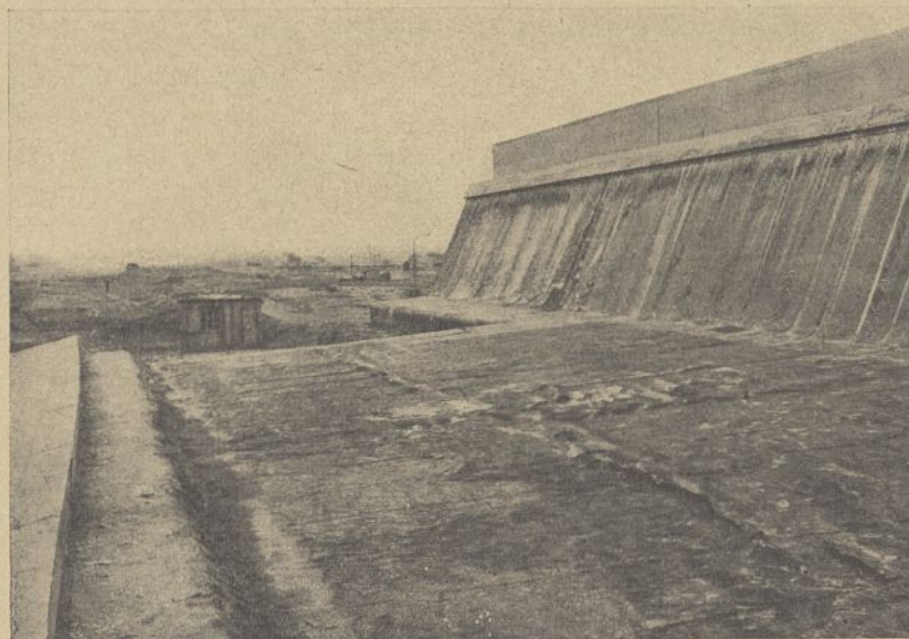
Abb. 6. Unterführung der Friedrich-Wilhelmstraße. Falten und Risse in der Bleidichtung, weil wegen zu niedrigen Schmelzpunktes das Bitumen zu weich wurde.
