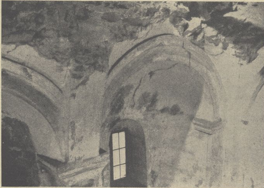
Abb. 41. Gewölbereste über dem Mittelpfeiler und der östlichen Nische der Nordwand der Magdalenenkapelle zu St. Emmeram in Regensburg.
