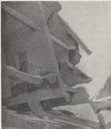
Abb. 23. Stonyfluß-Mauer. Trennungsfugen zwischen Pfeilern und Grundplatte luftseitig.
