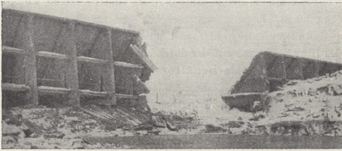
Abb. 22. Stonyfluß-Mauer. Bruchstelle mit dem durch das Wasser gespülten Kolk von der Luftseite gesehen.
