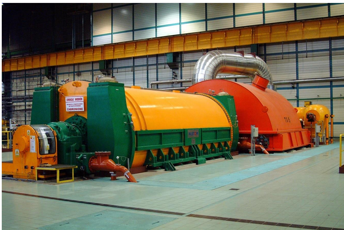
Rysunek 36 Widok generatora od strony aparatu szczotkowego (źródło: strona internetowa PGE S.A)
