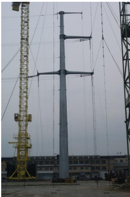
Rys. Z-B/1. Badanie słupa mocnego 400kV typu W4ONIz
