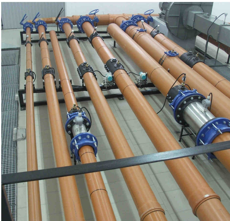
Rys. 15 Sekcja rurociągów przed modyfikacją
