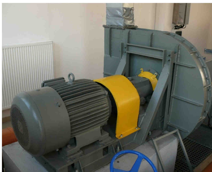
Rys. 16 Zespół wymuszający przepływ- silnik trójfazowy wraz z dmuchawą odśrodkową
