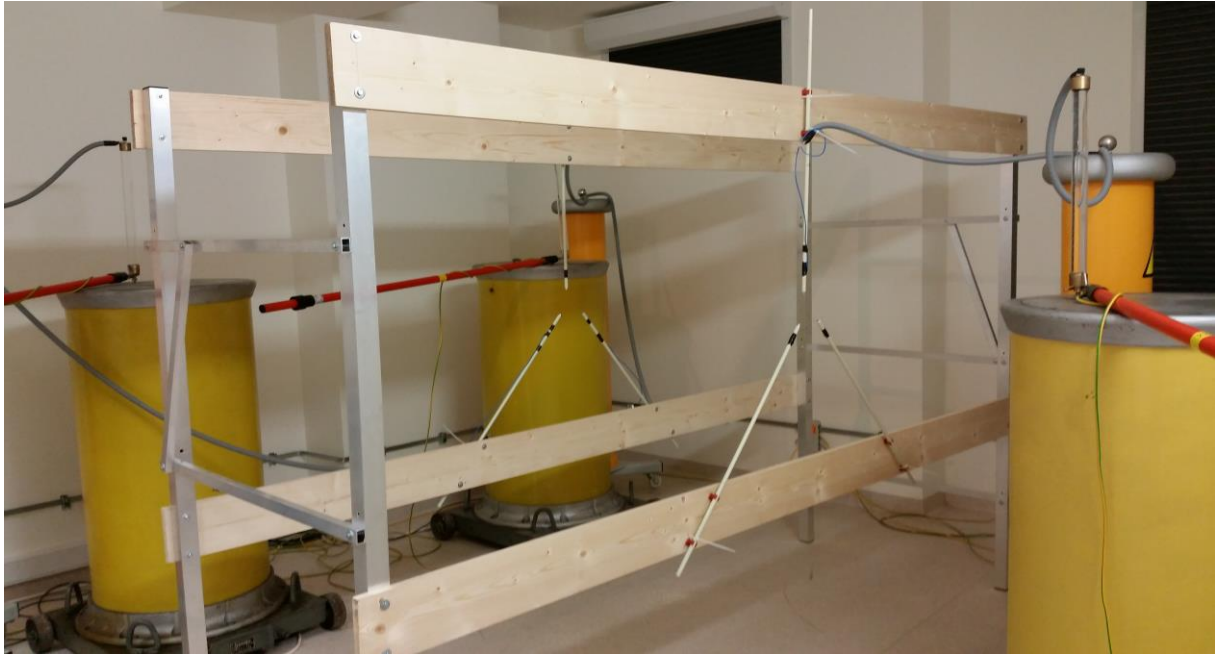
Rys. 6.3 Widok ogólny na stanowisko pomiarowe. Widoczne są trzy transformatory probiercze oraz pręty z włókna szklanego służące do mocowania przewodów badanej linii trójfazowej. [Zdjęcie własne].
