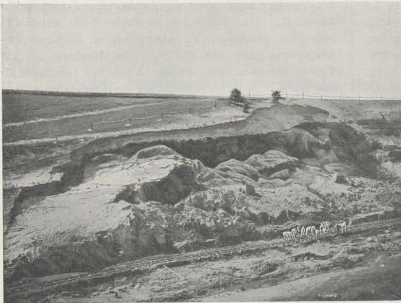
Abb. 23. Rutschung beim Aushub der Schleuse III bei Niederfinow.
