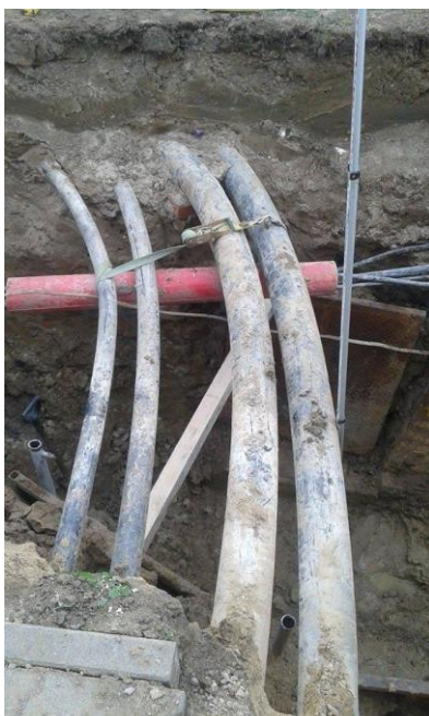
Rys. 6. Kolizja przy studni S13
