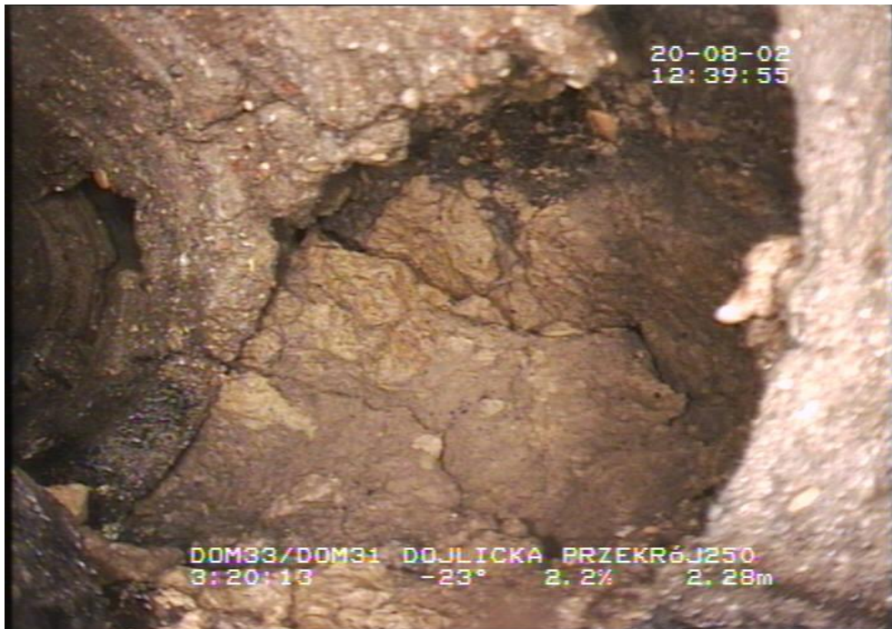
Rys. 3. Korozja ścian kanału betonowego
