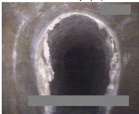
Rys. 5. Znaczna infiltracja spowodowana nieszczelnym złączeniem o widocznej inkrustracji zmniejszającej światło kanału
