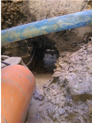
Rys. 7. Kolidza z przewodem kanalizacji deszczowej DN 1000
