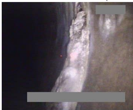
Rys. 6. Twardy osad odłożony na połączeniu
