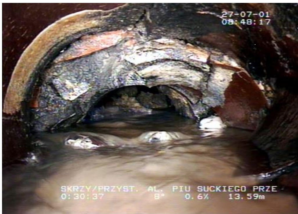
Rys. 9. Zawalenie się kanału kamionkowego
