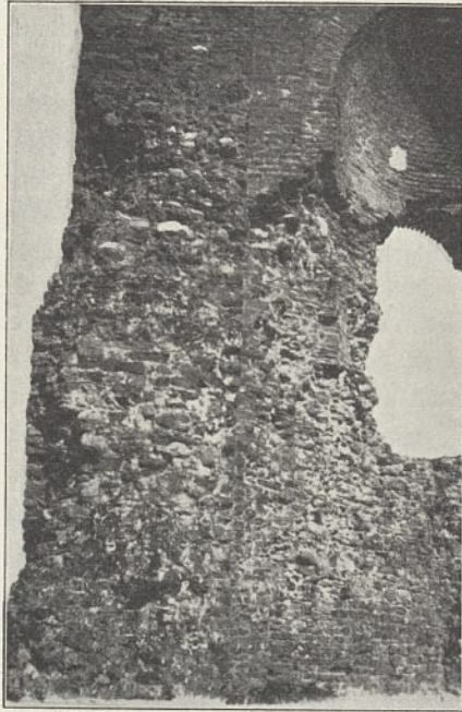
Abb. 1. Roccella: Mauerwerk an der Abbruchstelle zunächst der nördlichen Apsis.
