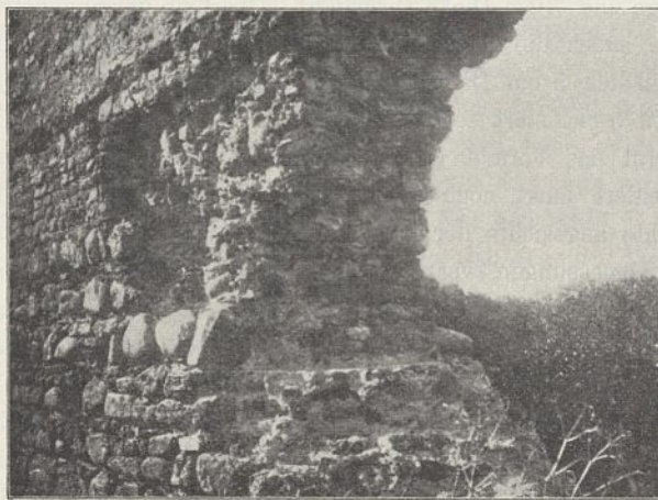
Abb. 2. Roccella: Mauerwerk an der Abbruchstelle der nördlichen Langhauswand zunächst dem Querschiffe.
