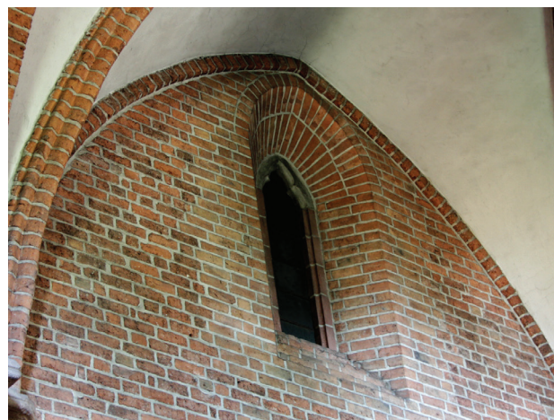
Il. 8. Wtórne okno w ścianie północnej nawy głównej, widoczne przemurowania powstałe przy zwężaniu, stan obecny (fot. M. Dąbkowska)
