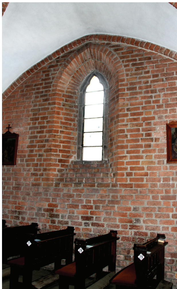
Il. 7. Wtórne okno w nawie południowej, widoczne przemurowania powstałe przy zwężaniu, stan obecny (fot. M. Dąbkowska)
