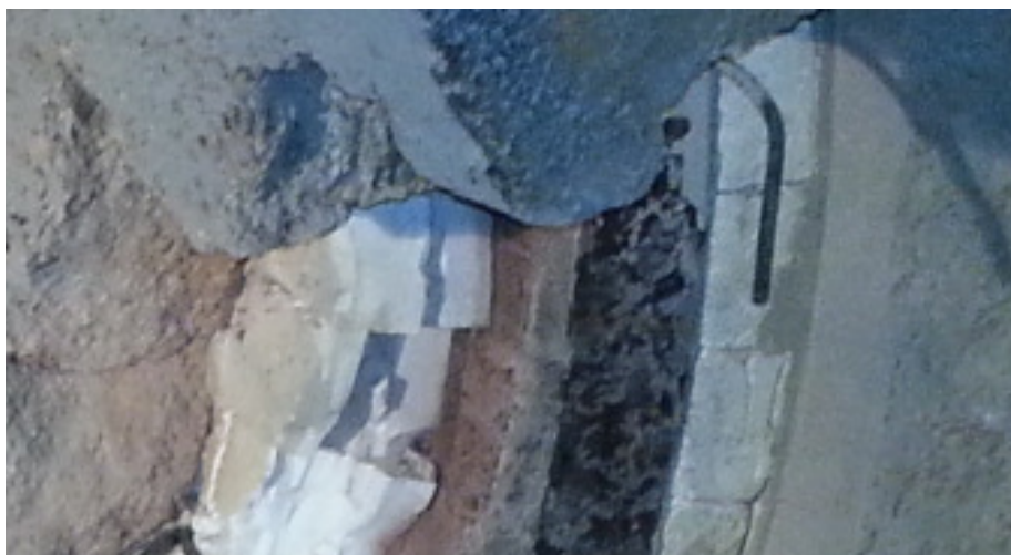
Fot. 2. Uszkodzenie izolacji komory spalania spowodowane przekroczeniem dopuszczalnej temperatury pracy.
