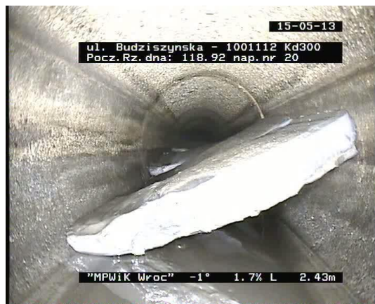
Rys. 7. Beton w kanale [13]
