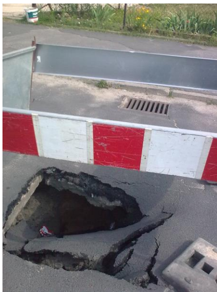
Rys. 6. Zapadnięcie jezdni po zawaleniu się kanału 0,3 m [13]
