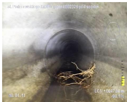
Fot. 1. Korzenie na złączu kanału \varnothing 300 mm
