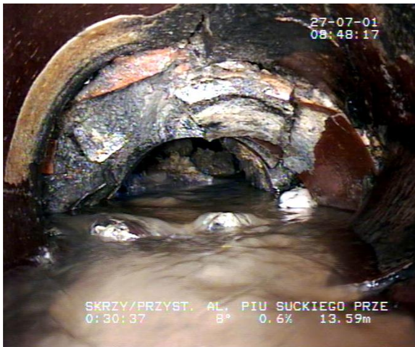
Fot. 7. Miejsce awarii na kanale kamionkowym kanalizacji sanitarnej
