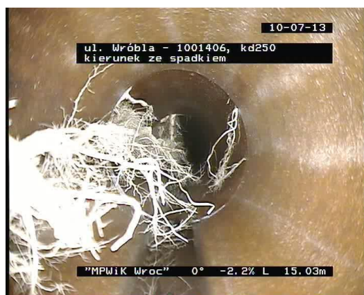
Rys. 8. Korzenie drzew wewnątrz kanału [13]
