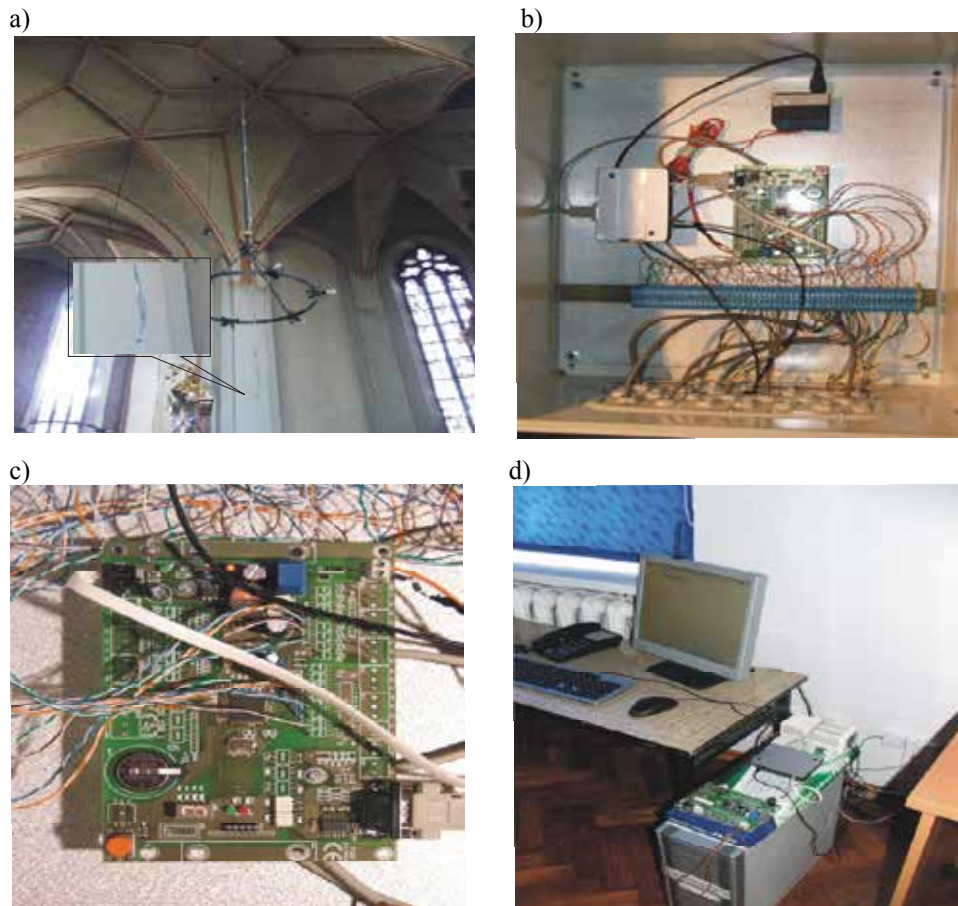
Rys. 6.15. Widok ogólny poszczególnych elementów układu do pomiaru, rejestracji, przesyłu i archiwizacji danych pomiarowych. a) linia z zainstalowanymi czujnikami DS18B20, b) układ pomiarowo-nadawczy, c) mikroprocesorowy układ pomiaru i rejestracji danych, d) stanowisko odbioru i archiwizacji danych
