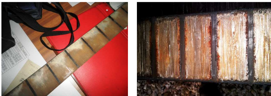
Rys. 6.20. Przykłady degradacji zewnętrznej ochrony przeciwjarzeniowej prętów generatorów
