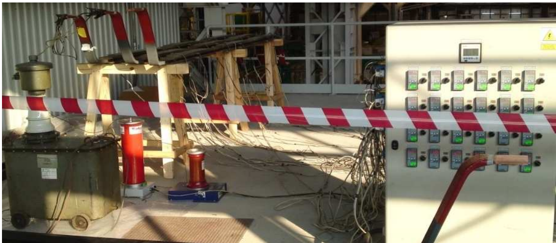
Rys. 6.1. Stanowisko do przeprowadzania prób starzeniowych uzwojeń
