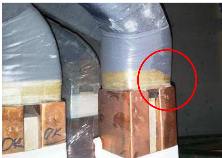
Rys. 5.27. Pręt stojana generatora z nieprawidłowo nałożonym lakierem półprzewodzącym
