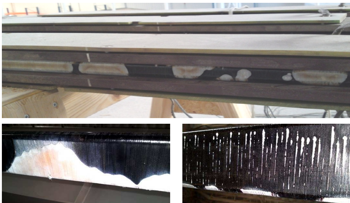
Rys. 6.19. Uszkodzenie zewnętrznej ochrony przeciwjarzeniowej pręta
