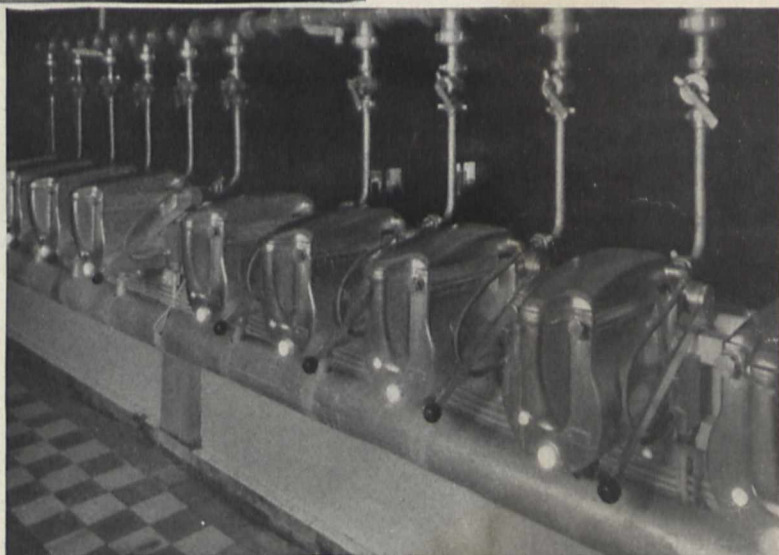
Bild 3 (unten). Anlage zur Milchvitaminisierung in Frankfurt am Main
