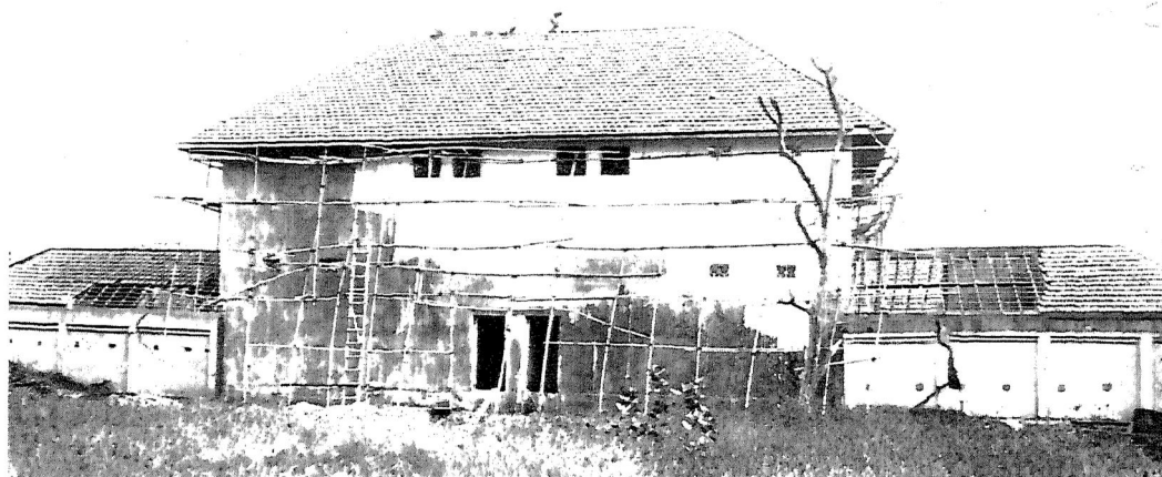
Abb. 79. Abreißen leichter Anbauten vom Hauptgebäude infolge geringerer Setzung.
