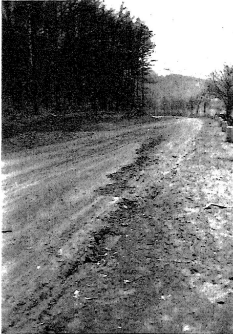
Abb. 58. Gefährdung eines Straßenkörpers durch Böschungsrutsch.
