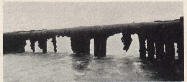
Bild 2. Durch Bohrmuschelfraß zerstörte Buhne bei Borkum. — Die abgefressenen Pfähle bestehen aus Fichtenholz; die scheinbar noch gesunden aus Eichenholz; doch auch diese sind bereits angebohrt
