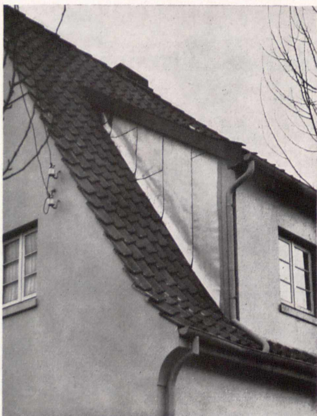
Bild 3a. Ein nicht werkgerechter Dachaufbau Das Seitendreieck statt ebenfalls aus Pfannen — mit Dachpappe benagelt und mit Silberbronze angestrichen!
