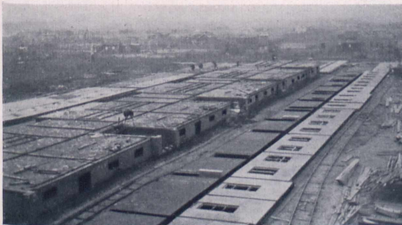
Fig. 2. Fertiggestampftes Kellermauerwerk. Rechts die fertigen Wandplatten für das erste Geschöß, mit den eingeformten Fenster- und Tür-Rahmen. Dazwischen das eine Gleis des Laufkrans. Auf der anderen Seite und auf der Querseite (hinten) der Baugrube ebenfalls Reißböden mit Platten.
