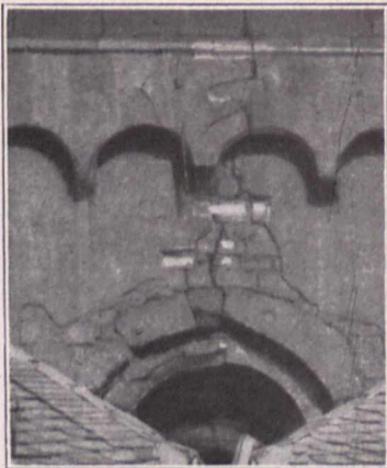
Fig. 3 (links). Risse im Mauerwerk.
