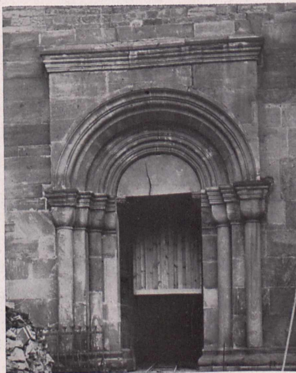
Fig. 7. Das nördl. Portal der Ostseite am Liebfrauenplatz. Der Türsturz ist durchgebrochen. Die Risse setzen sich nach oben, über das Bild hinaus, bis ans Dach etwa 30 m hoch fort.
