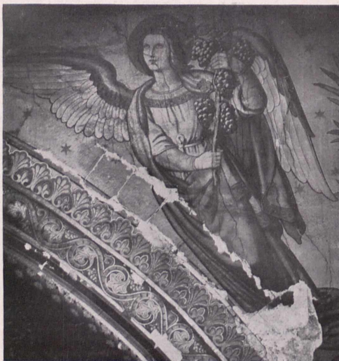
Fig. 8. Auch an der Decke zeigen Mauerwerk und Malerei Risse.
